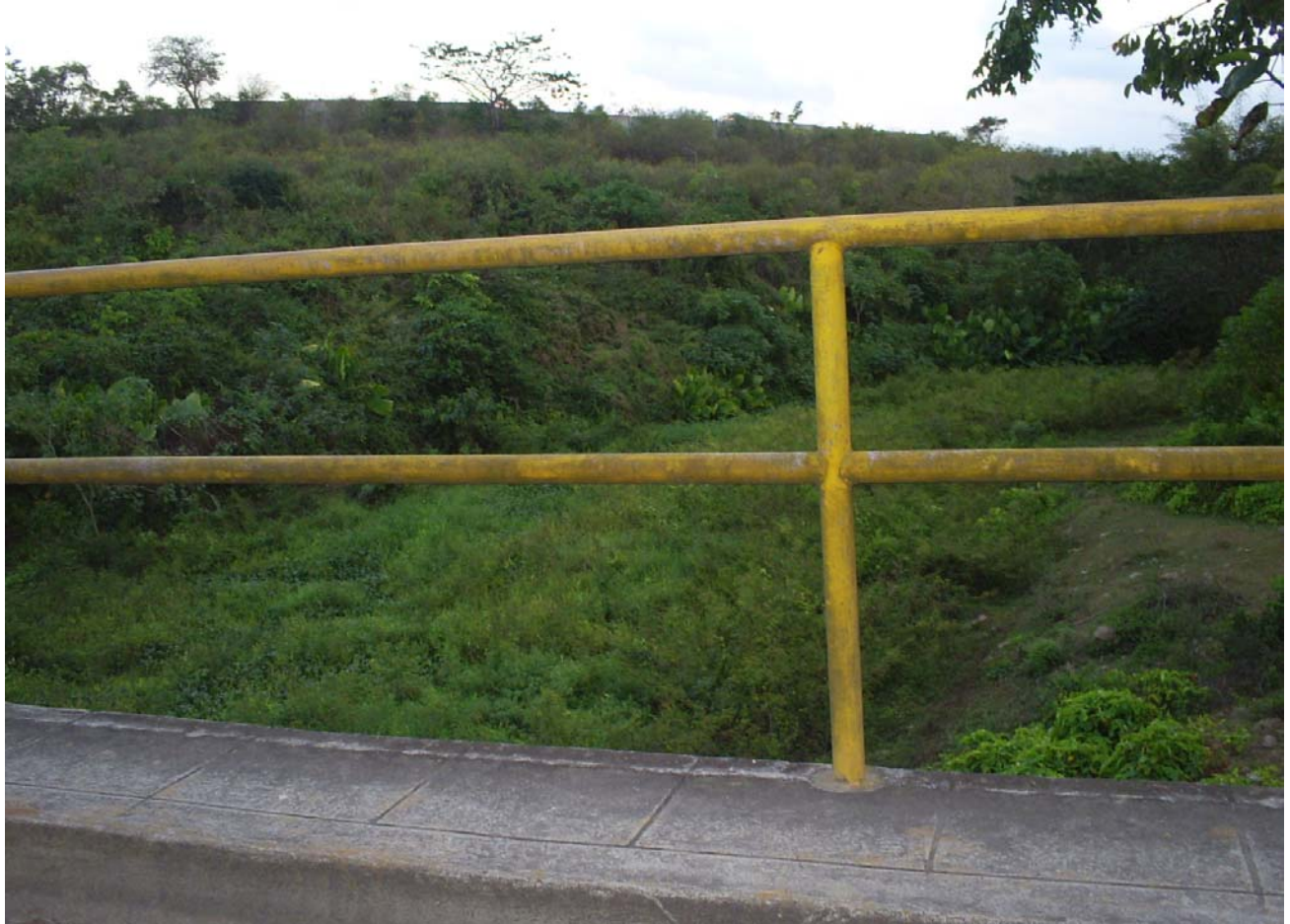
Almendrares cubierto de vegetación invasora, Puente de Hierro, Taza de Vento, 5 de enero de 2013.
